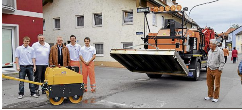
Unter anderem informierte sich Bürgermeister Schadenfroh im Oberanger über das neuartige ökologische System der Schlaglochreparatur der Firma Instratec.
