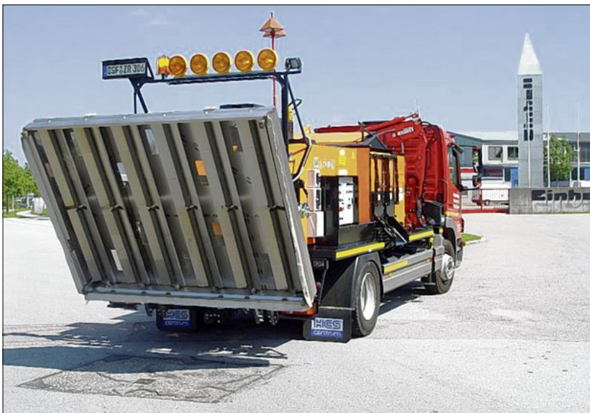
Die Firma Instratec wird am Maimarktsonntag ihre neue ökologische Art der Straßenreparatur im Oberanger vorführen. (Foto: Zinner)
